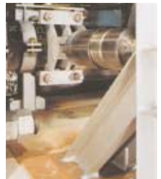
Exemples de montage de DAB en centrale nucléaire.
